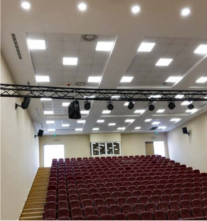
Konyaaltı Belediyesi Kültür Salonu Tavan ve Merdiven Aydınlatma
